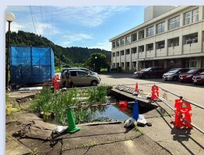
使用できなくなった浄化槽
