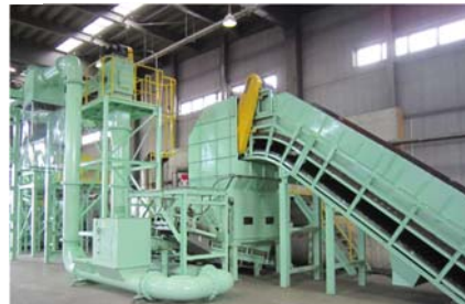
破砕・圧縮固化機
