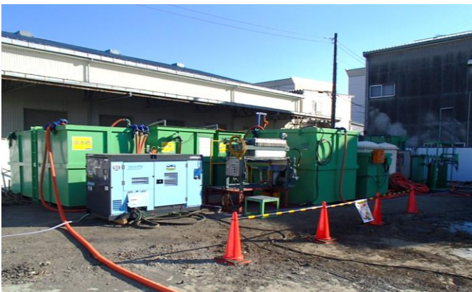
現地水処理プラント
