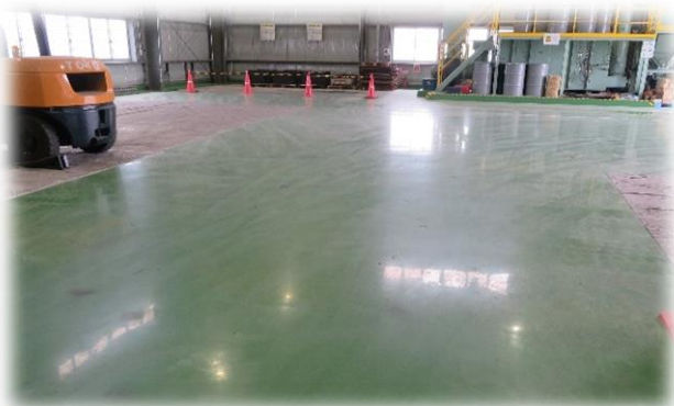
▲エポキシ樹脂で塗装された床（NTC）
