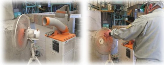
▲工場内に扇風機・スポットクーラーを設置
