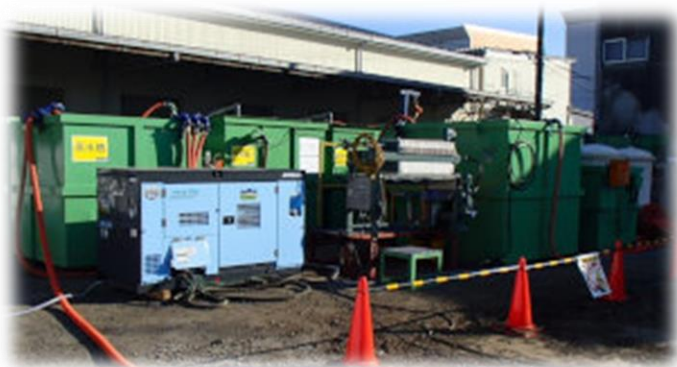
▲現地水処理プラント
