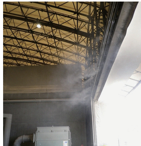
▲テント建屋入口におけるミストカーテン（大阪RC）
