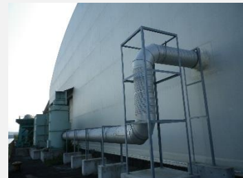
▲VOC 吸着設備(活性炭)
