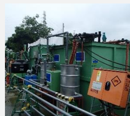
▲現地水処理プラント
