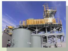
重金属洗浄設備
