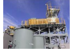
重金属洗浄設備
