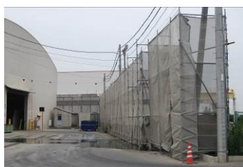
防じんネット (名古屋リサイクルセンター)
