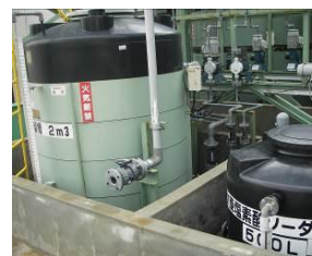
処理薬品タンク
