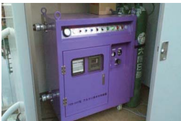
pH調整装置 (横浜リサイクルセンター)
