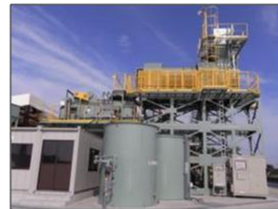
洗浄設備(重金属)
