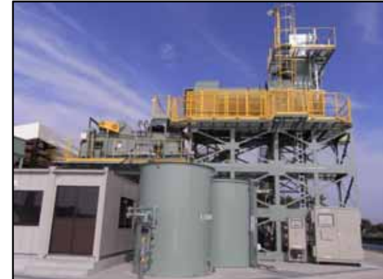
洗浄設備(重金属)
